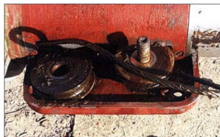
Bild 6: Zwei Umlenkrollen am Hauptrohr; Seil verklemt
