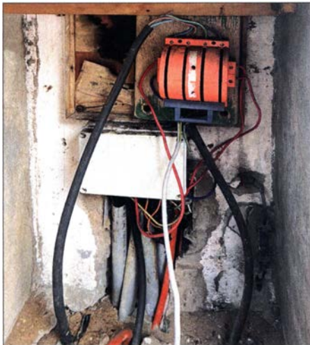
Mit solchen Elektroinstallationen muss man in Afrika rechnen.
