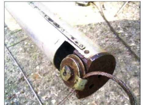
Bild 13: Umlenkrolle mit Aufzugseil am untersten Segment
